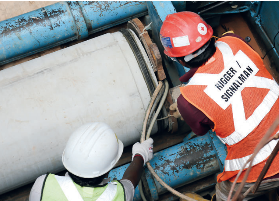
Укладка труб для микротоннелирования Perfect Pipe в первом проекте подобного рода в Сингапуре (см. выпуск журнала «Международное бетонное производство» 2/2016)
